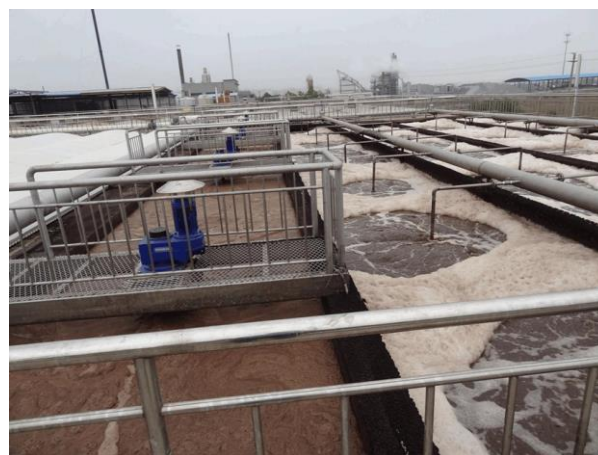
Fotografía 1: Tratamiento de pre-desnitrificación y tratamiento biológico aeróbico
